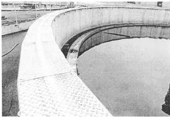
Das Nachklärbecken ist die letzte Station: Das klare, gereinigte Wasser kann nun oben über eine Rinne abfließen und über einen Vorfluter dem Main zugeführt werden.
